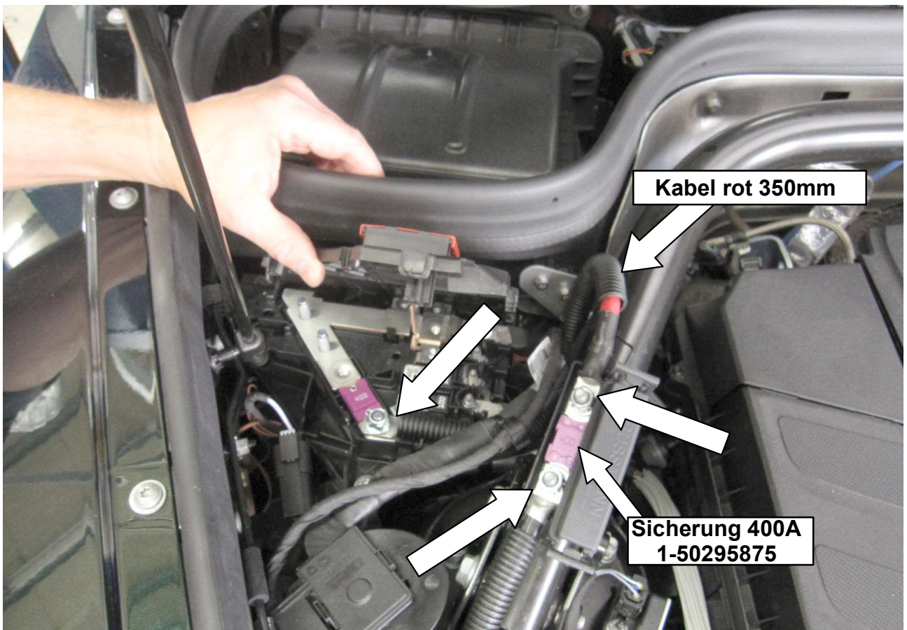
27 Pluskabel anschließen / Connect plus cable!
